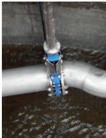
Станция очистки сточных вод, Зеерберген, Германия VAG ZETA® Ножевые задвижки
