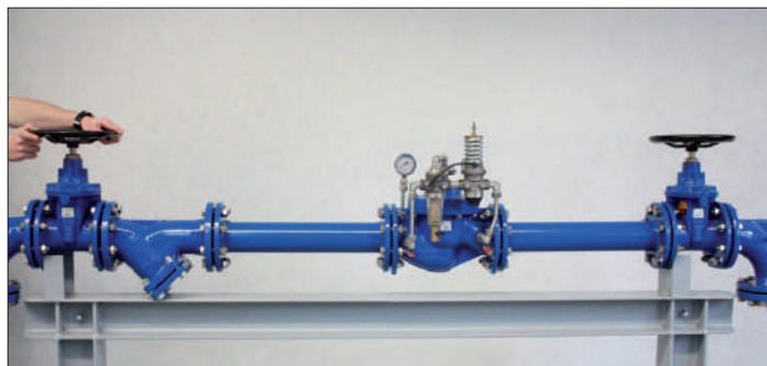
Рис. 18: Частичное открытие запорной арматуры перед РК
