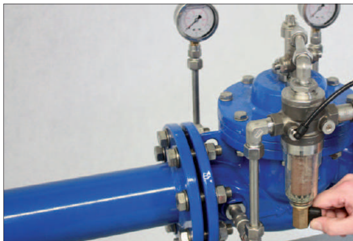
Рис. 27: Открытие стопорного крана
