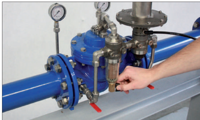
Рис. 34: Открытие стопорного крана
