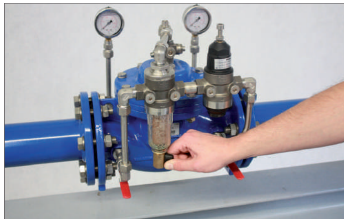
Рис. 10: Открытие стопорного крана
