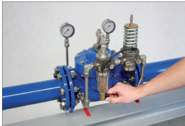
Рис. 19: Открытие стопорного крана
